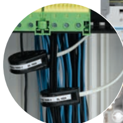
Tores en aval disjoncteur
